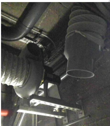
Gaine de rejet de l'air vicié extrait du local acide
