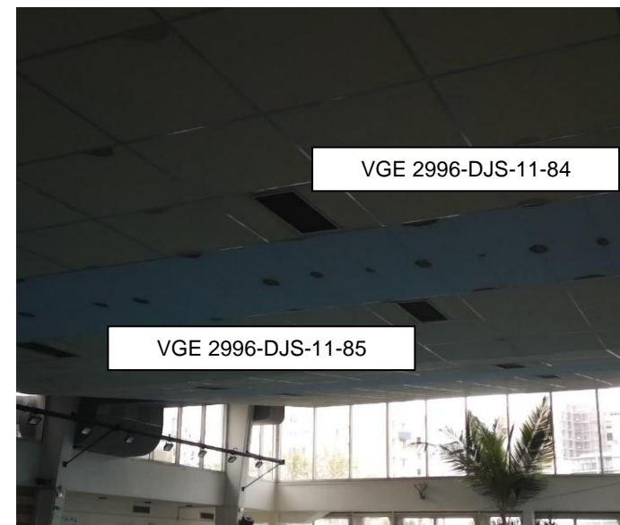
Bouches de reprise VGE 2996-DJS-11-84 à 91
