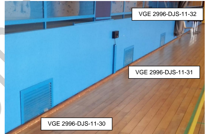
Bouches de reprise VGE 2996-DJS-11-24 à 33
